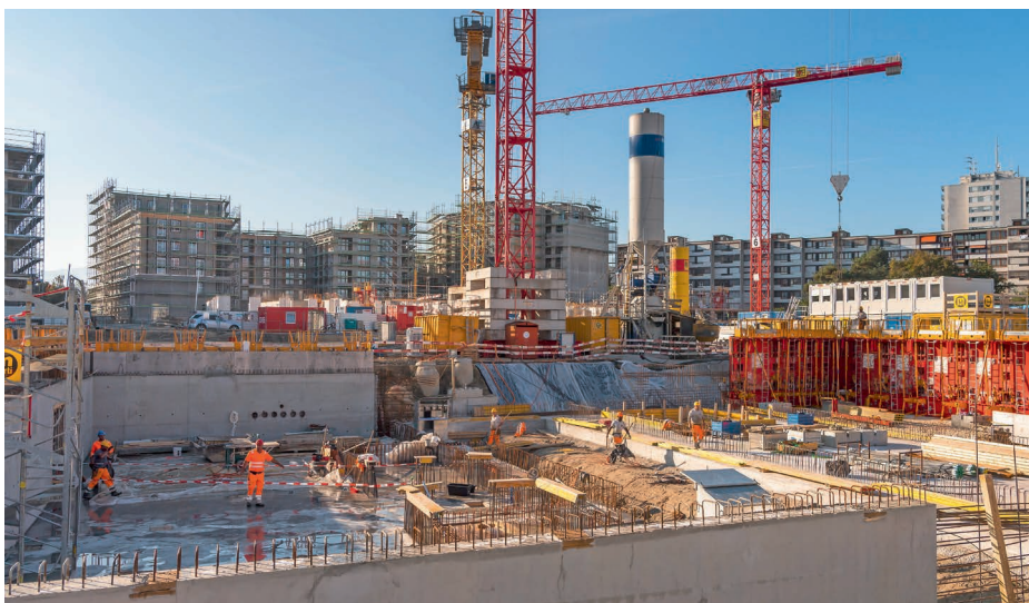
Le chantier des Plaines-du-Loup, sur les hauts de Lausanne, en 2021. | Image Keystone
